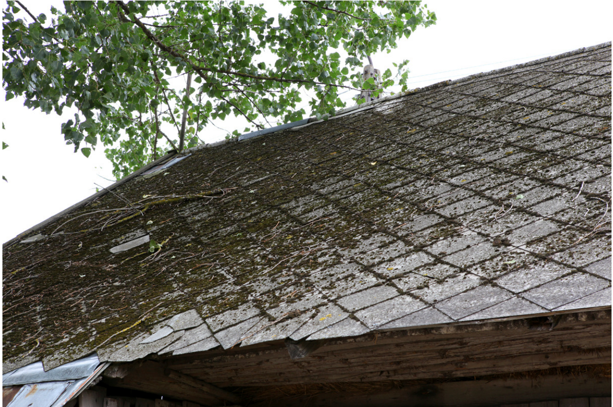
Fot.7. Przykład pokrycia dachowego z użyciem płyt zawierających azbest typu "karo", gmina Szudziałowo.
