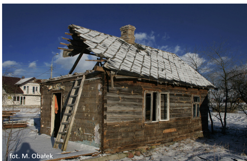
Fot.4. Przykładowe zagrożenie spowodowane niszczeniem pokryć dachowych, z których uwalniają się włókna azbestowe.
