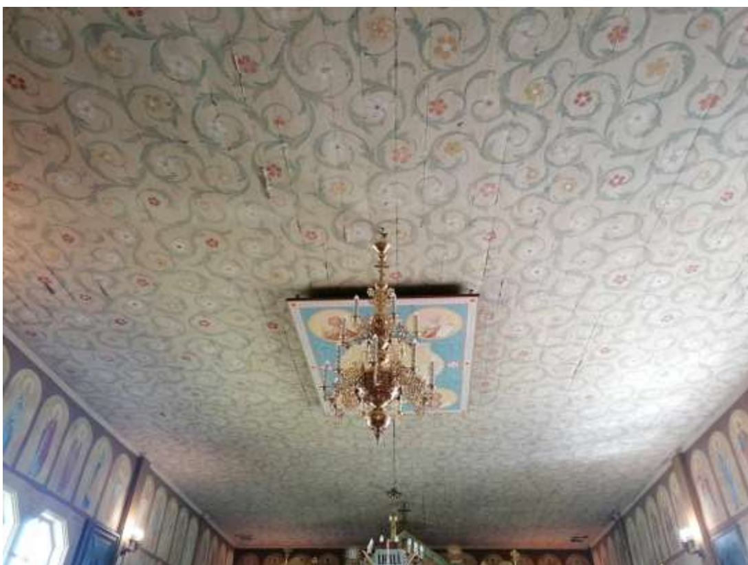
Fot. 6. Wnętrze budynku- nawa główna / widok na sufit (przeznaczony do remontu).
